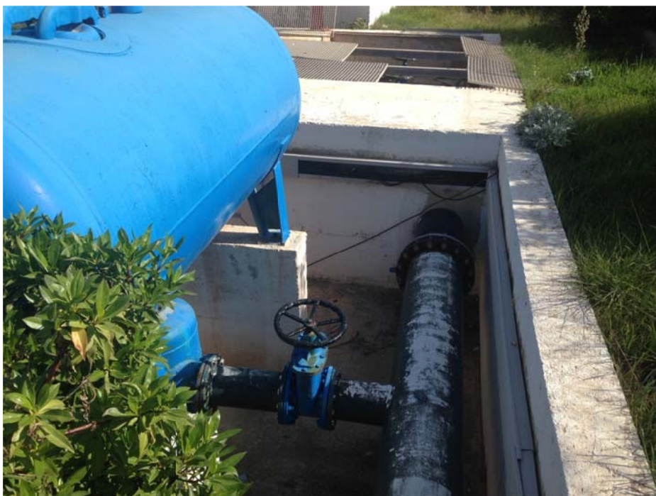
VISTA CALDERÍN Y VÁLVULA
