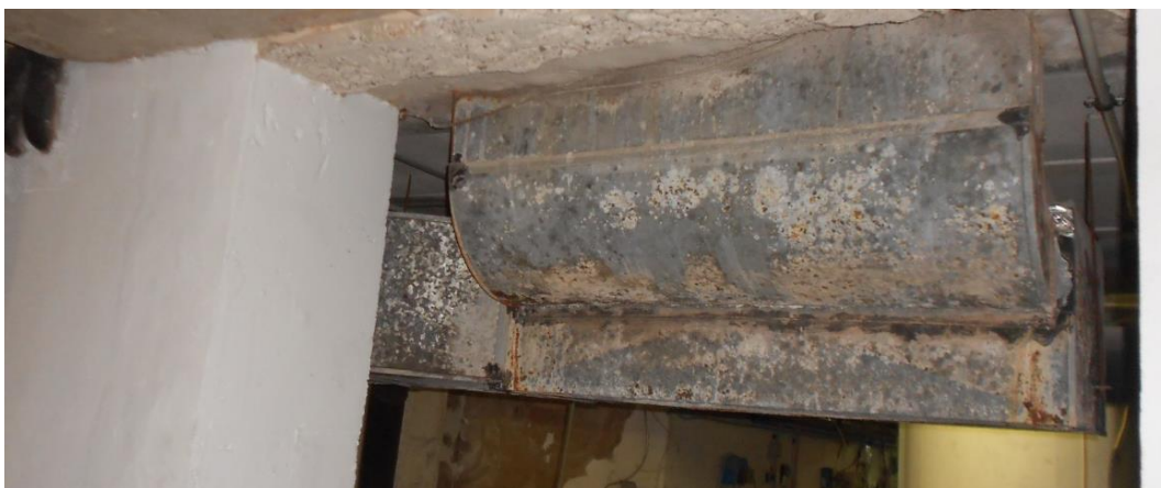
Il·lustració 2) Conducte de retorn d'aire interior molt deteriorat per corrosió ambient
