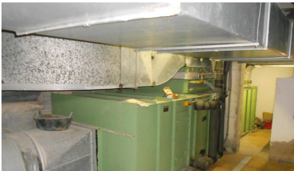
Il·lustració 3) Unitat de tractament d'aire existent, conductes de retorn en bon estat
